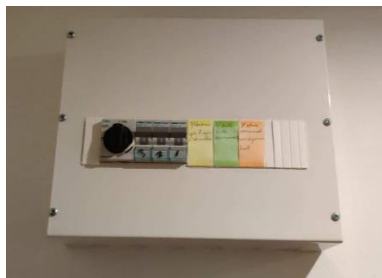
Modern elcentral utan jordfelsbrytare
